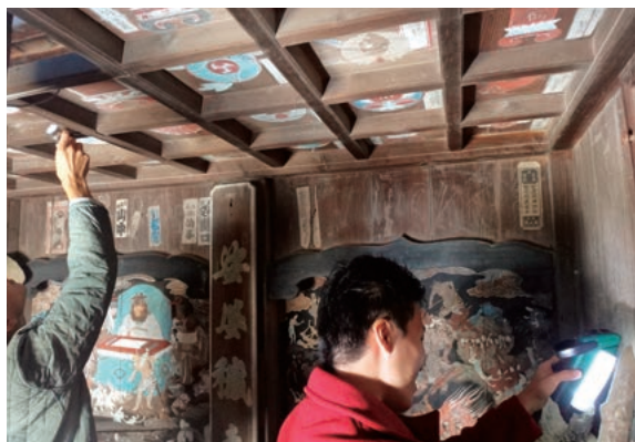
鐘楼の落書調査
